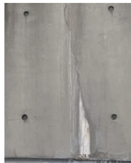
経年コンクリートの改質なしにひび割れ集中箇所をポリマーセメントで被覆補修してもひび割れはまた発生します。
