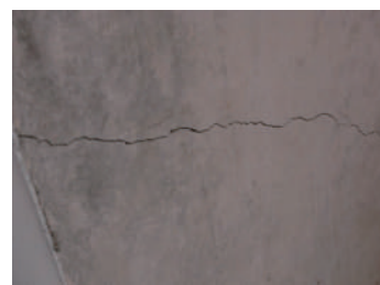
軒天のひび割れ
